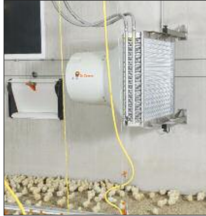
Einsatz des HeatMaster 2 H im Hähnchenstall
