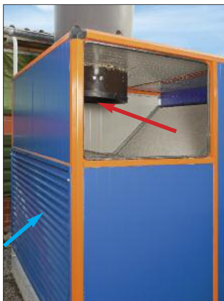
Frischlufzufuhr und Abluft, die aus dem Wärmetauscher abgesaugt wird
