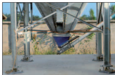
Waga elektroniczna pod silosem
