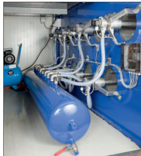
Automatyczne czyszczenie kompletu filtrów sprężonym powietrzem
