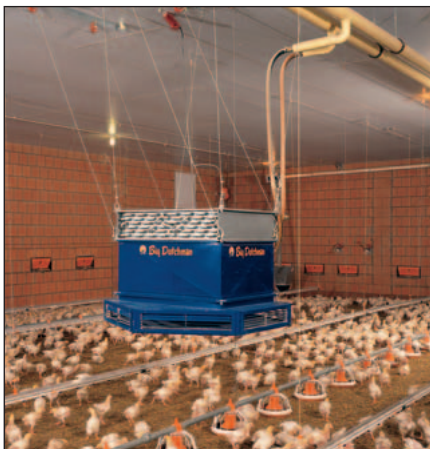
Zastosowanie HeatMaster 40 R w kurniku
