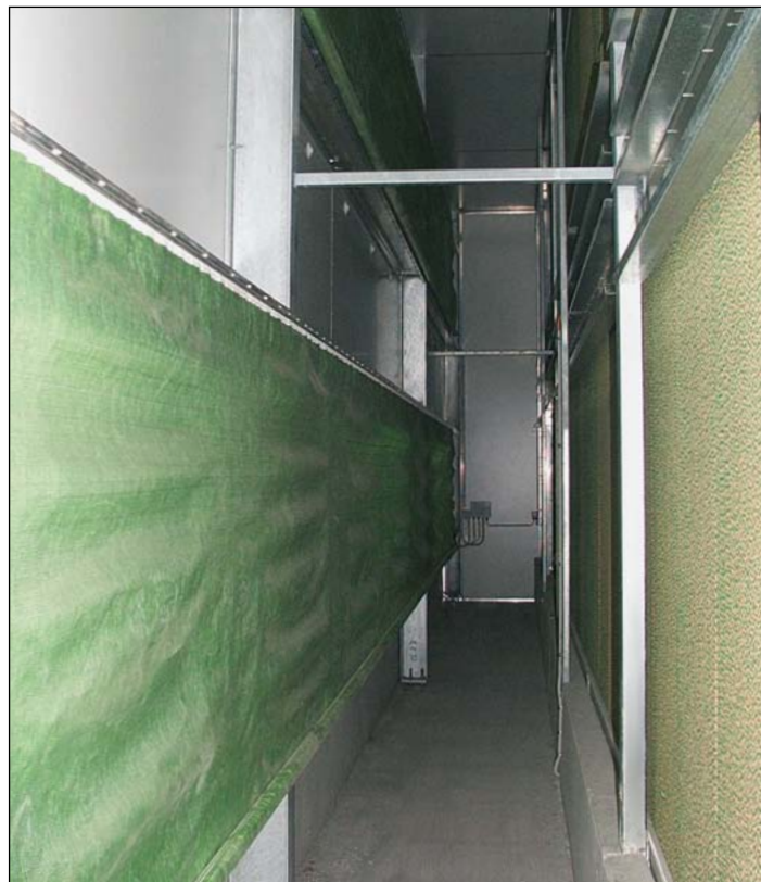
Впускное отверстие тоннеля с гардиной
