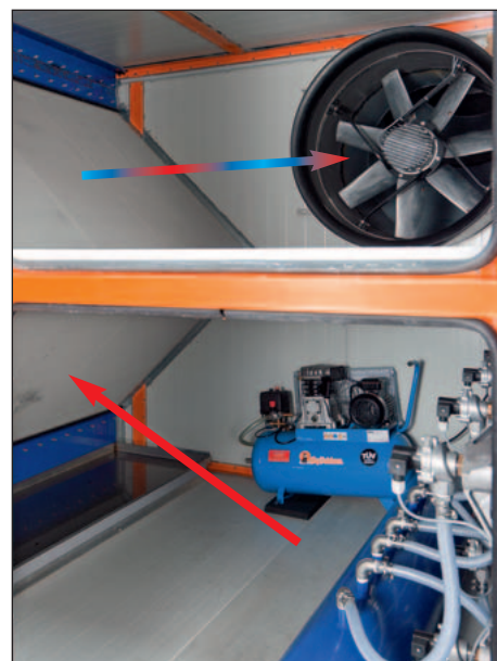
Очищенный отработанный воздух засасывается вентилятором (сверху); подогретый свежий воздух поступает в птичник (снизу)
