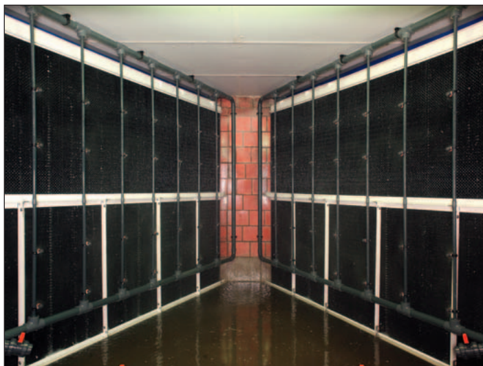
Группа форсунок распыляет воду по лицевой стороне фильтрующей стенки
