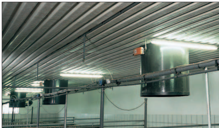
Применение осевых вентиляторов в помещении с щелевым потолком
